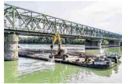
Sanierungsbedürftige Donaubrücke in Mauthausen Foto: Fotokersch
